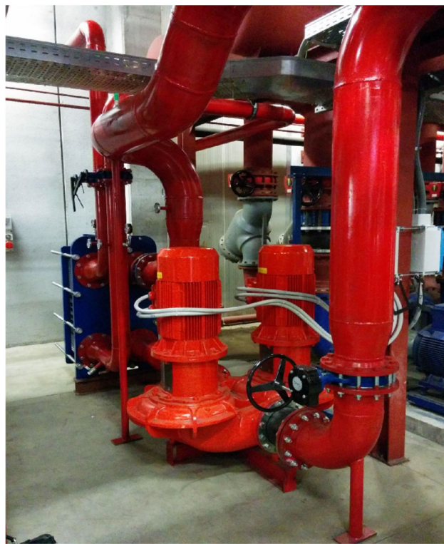
Rho Fiera Milano: Scambiatore e gruppo pompaggio acqua di falda per condensazione gruppo frigorifero
