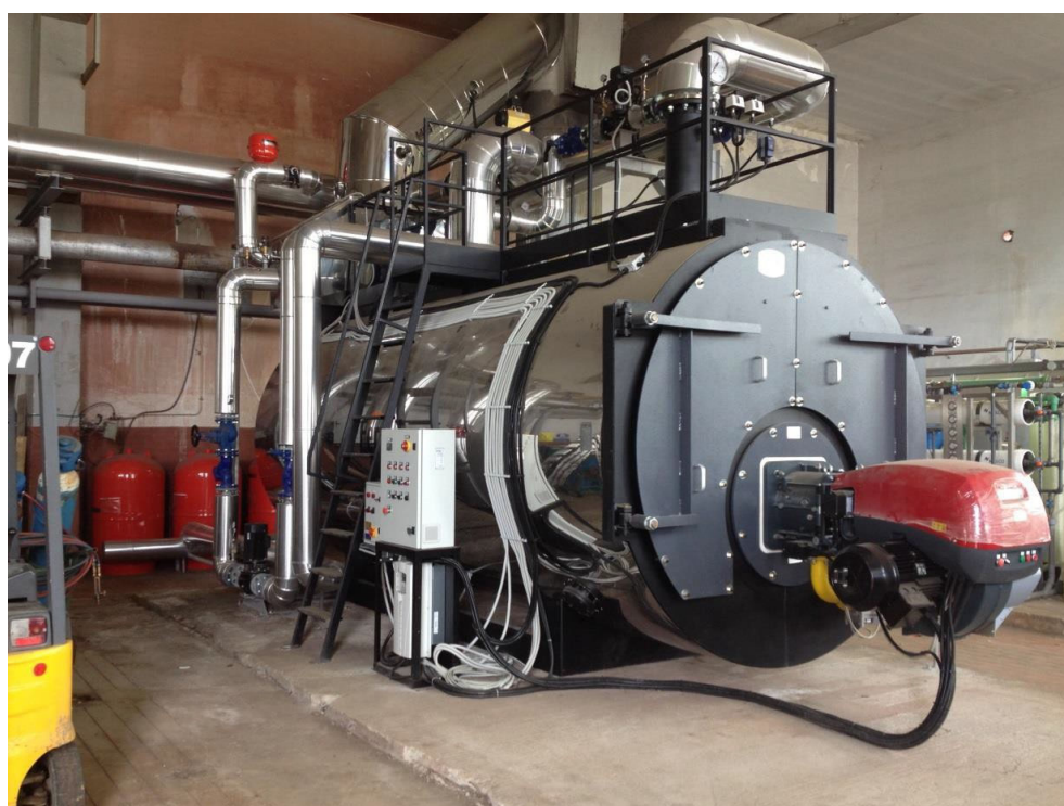
Efficientamento centrale termica Policlinico: n°1 caldaia ad acqua calda da 5.200 kW
