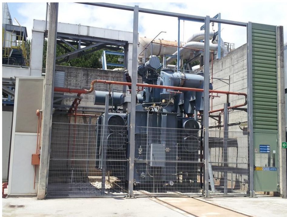
Trasformazione ciclo combinato – ciclo semplice: trasformatore elevatore 11kV/150kV – 65 MVA
