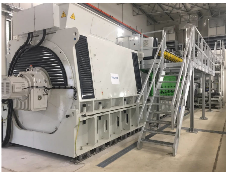
Trigenerazione FCA Cassino: Vista interno sala macchine – alternatore
