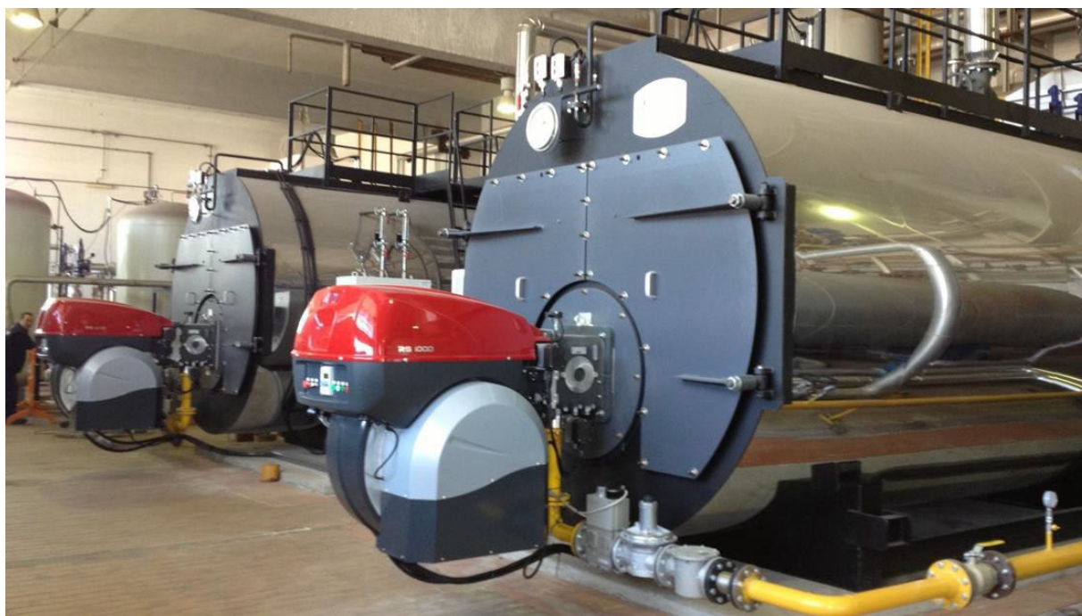
Efficientamento centrale termica Policlinico di Messina: n°2 generatori di vapore da 6.975 kW
