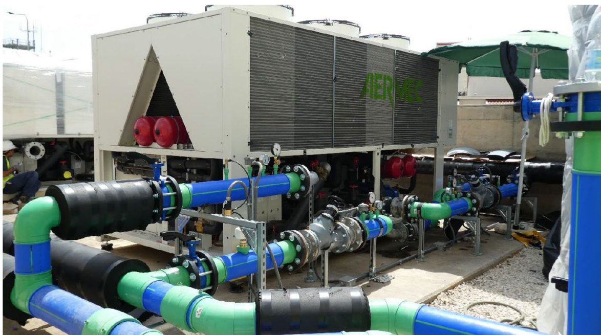
Base Nato Sigonella: Gruppo frigorifero polivalente ad alta efficienza a servizio edificio 465
