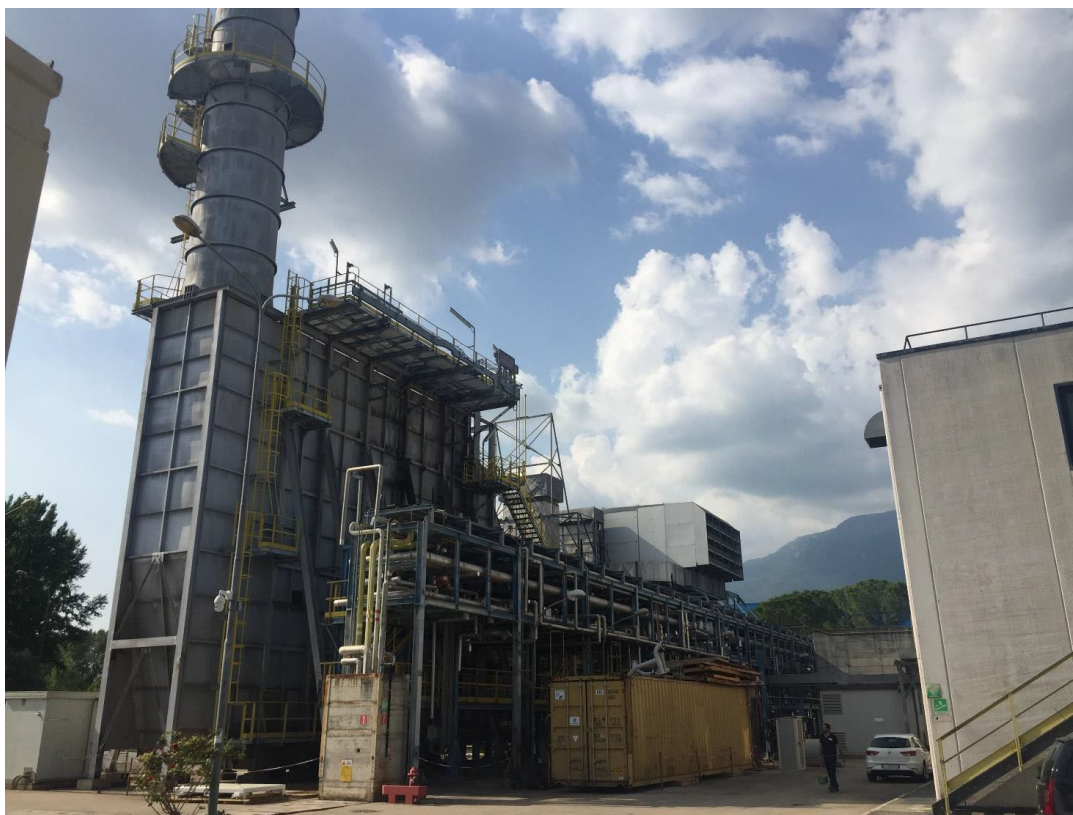
Trasformazione ciclo combinato – ciclo semplice: vista caldaia a recupero modificata
