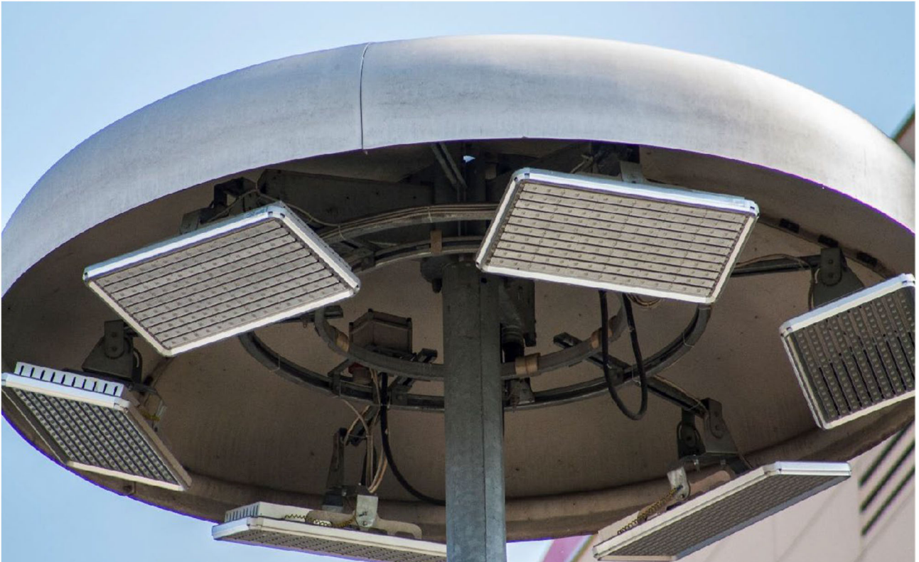
Rho Fiera Milano: Particolare proiettori a led montati su torri faro.
