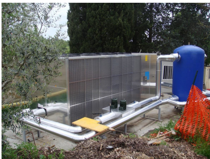
Clinica Ulivella Firenze: Gruppo frigorifero a servizio del blocco operatorio
