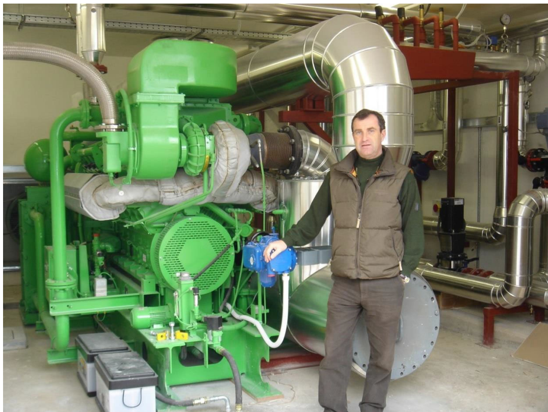
Impianto trigenerazione ICOT Latina: Cogeneratore GE JENBACHER 600 kW installato in locale insonorizzato 60 dbA a 10 mt
