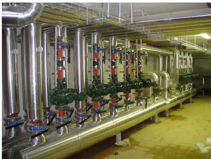
Clinica Ulivella Firenze: Sottocentrale distribuzione fluidi termovettori
