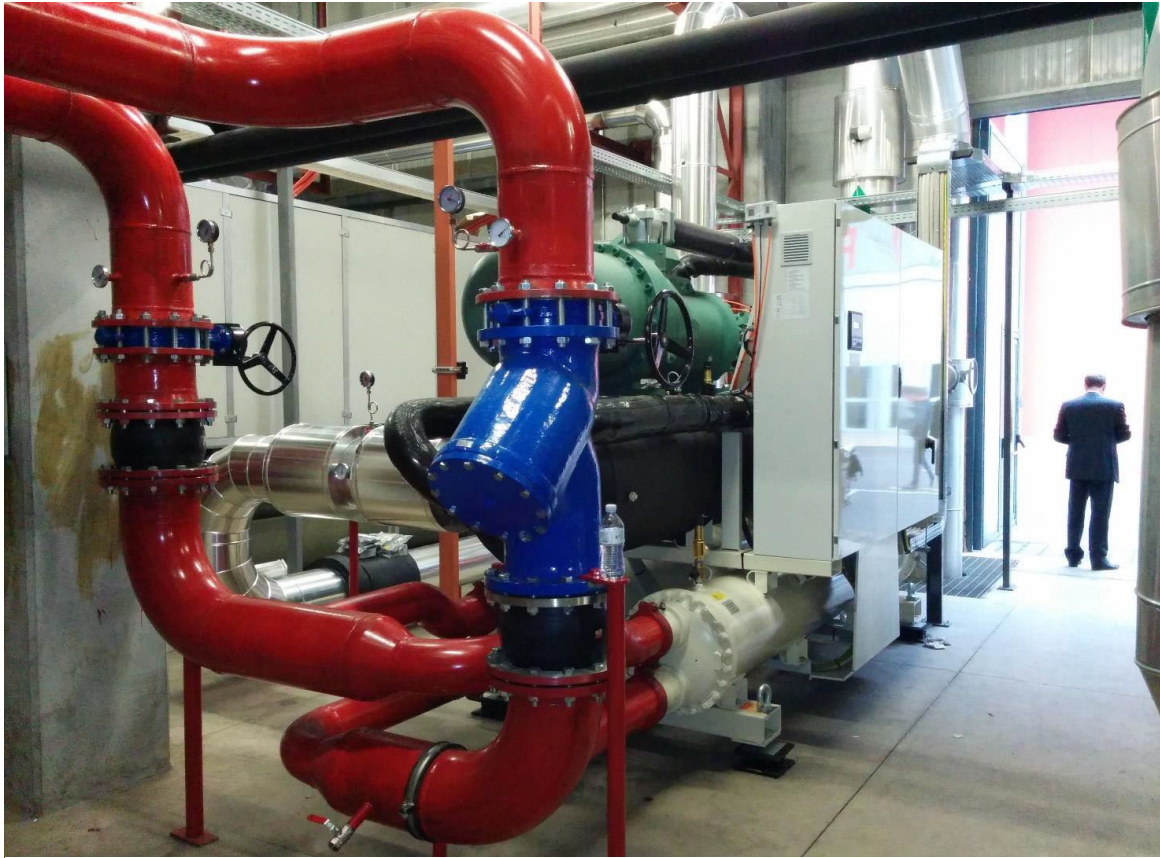
Rho Fiera Milano: Gruppo frigorifero geotermico 1500 kW per il Centro Servizi
