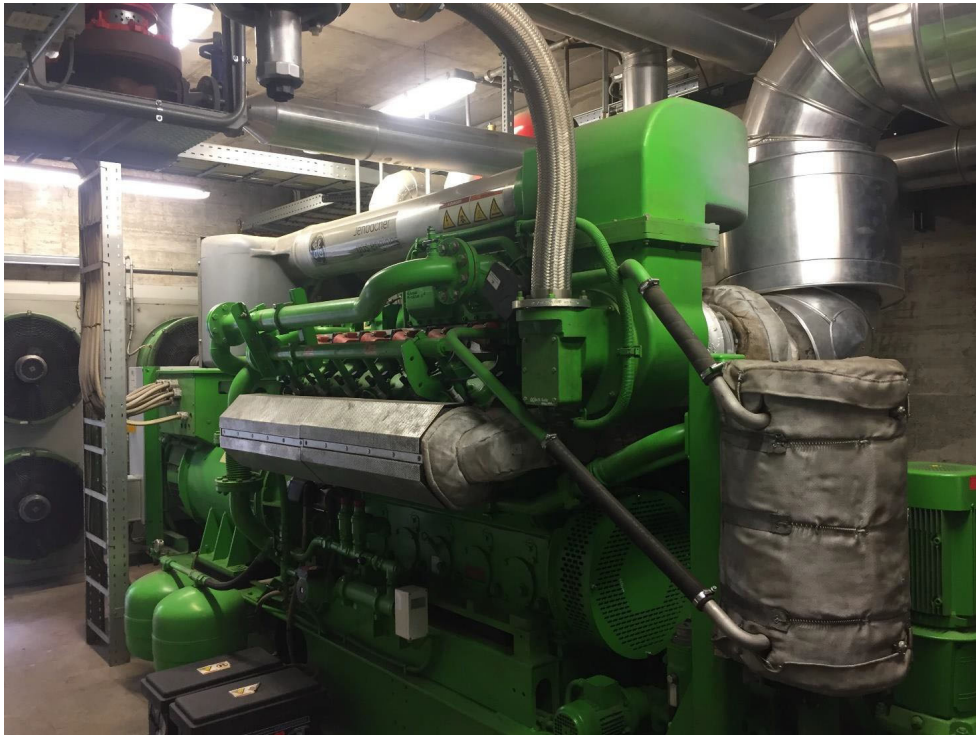
Trigenerazione Policlinico Casilino 1 Cogeneratore 630 kW in locale insonorizzato 65 DbA a 10 mt
