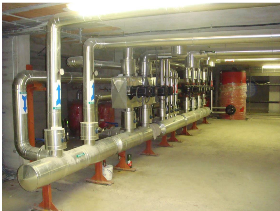
RSA ICOT Latina: Sottocentrale distribuzione fluidi termovettori da rete teleriscaldamento - teleraffrescamento
