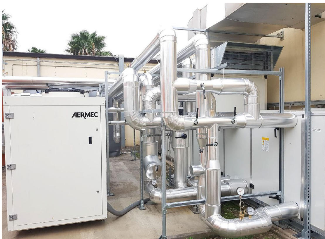
Base Nato Sigonella: Gruppo frigorifero polivalente ad alta efficienza e UTA a servizio edificio 568
